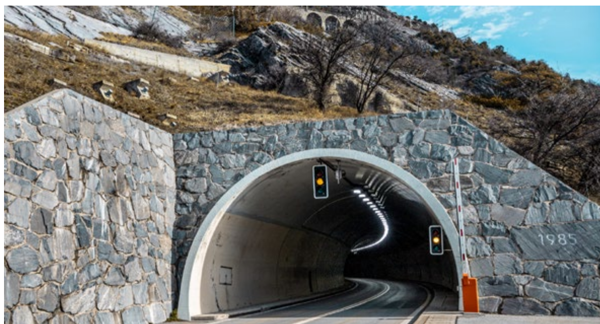
Auf der A6: LED-Beleuchtung im Mittel-Tunnel im Wallis zwischen Goppenstein und Gampel.
